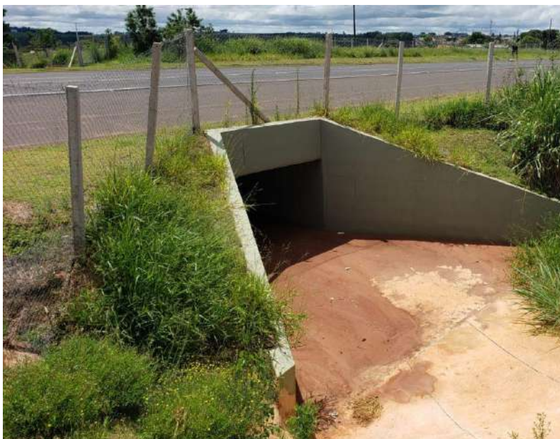
Foto 1 – Imagem ilustrativa de um modelo de passagem de fauna com cercamento
